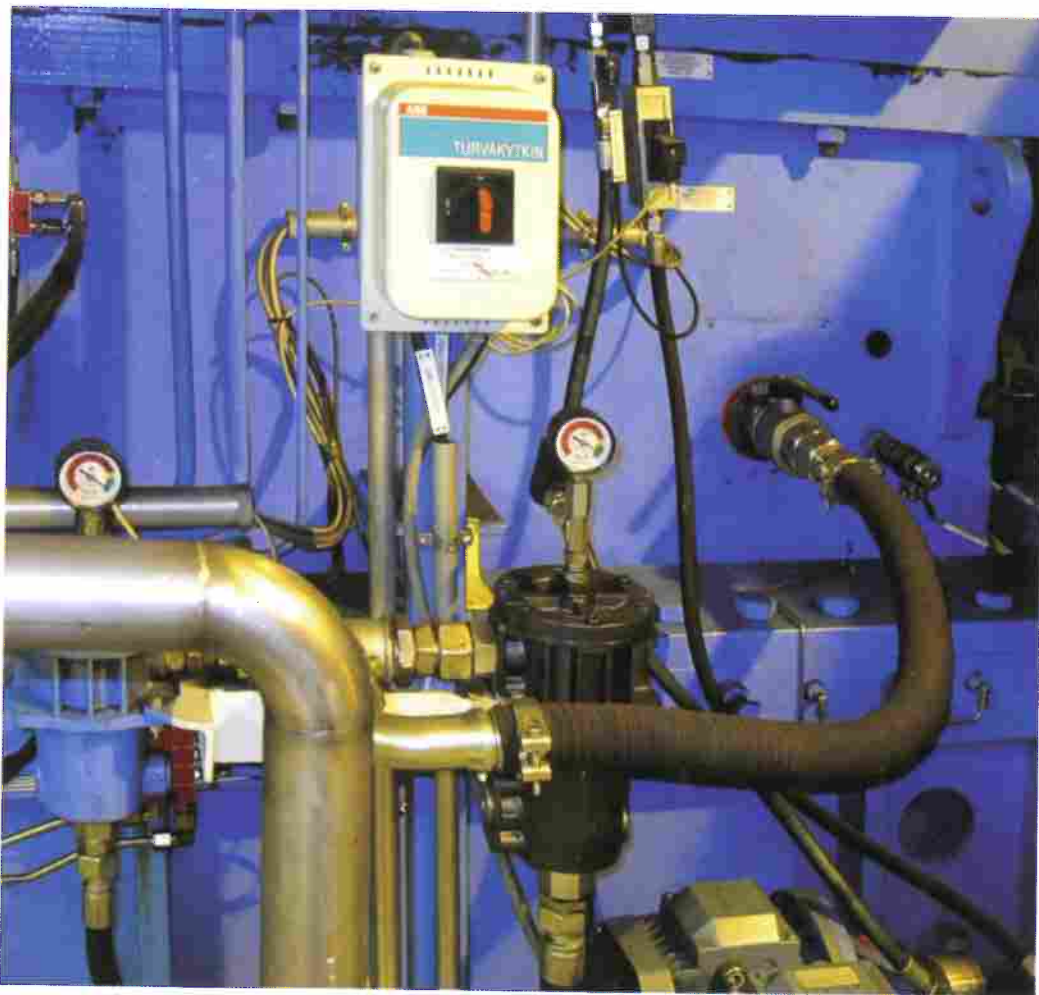
KUVA 2. Halkaisulinjan päällekelaimen vaihteistoöljyn mittapisteen hana tulpattuna.
